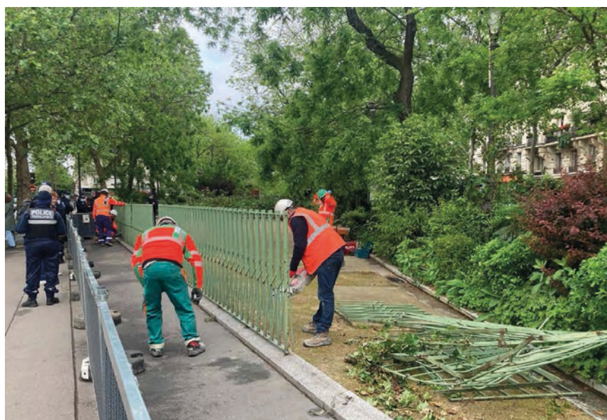
Destruction des grilles de squares du boulevard Richard Lenoir © FNE Paris
