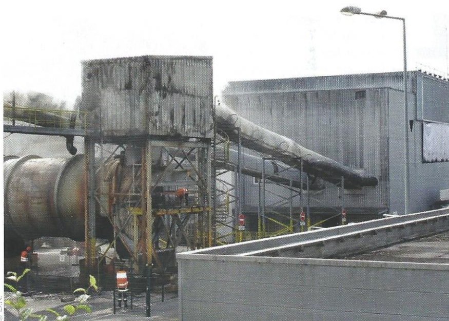
État de l'installation après l'incendie
