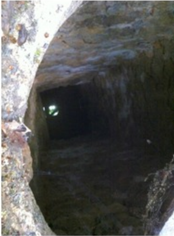
Aqueduc souterrain pour l'alimentation en eau des fontaines de Versailles (plateau de SACLAY) Association : ADER
