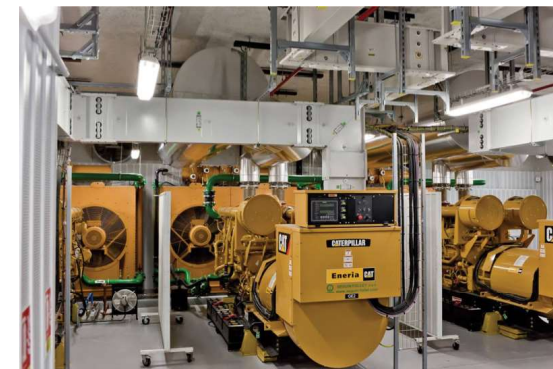
Stockage combustibles proche seuil Seveso
